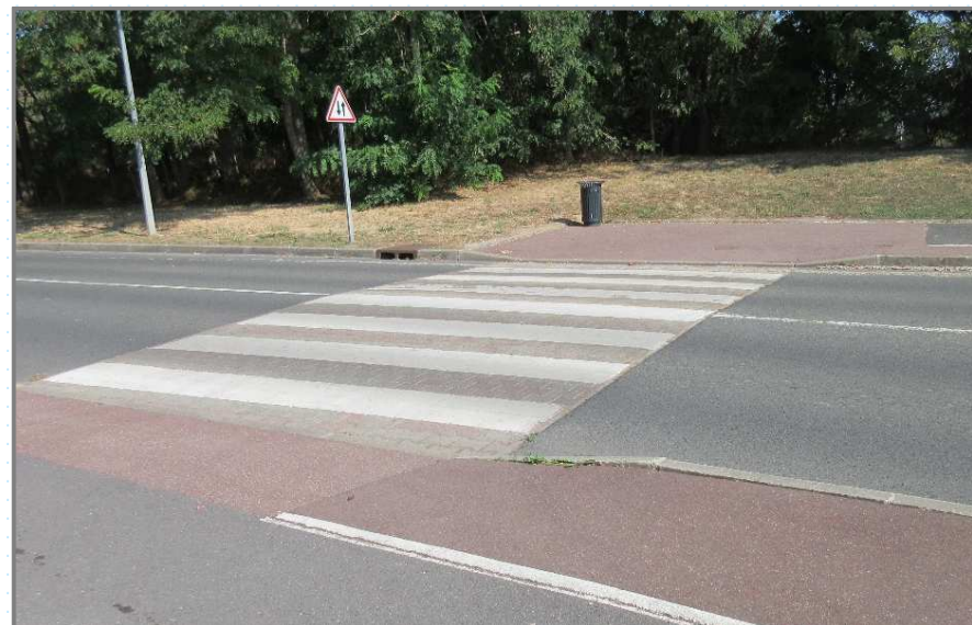
Pas de continuité vélo sur les traversées de chaussée, uniquement piétonne
