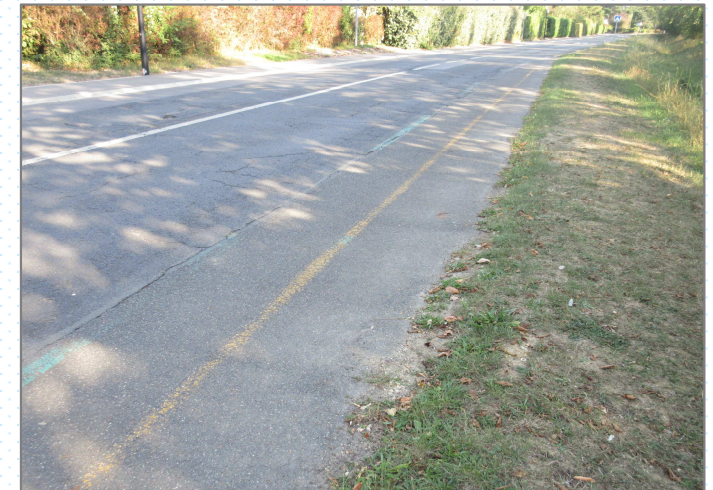
Marquages peu clairs en bord de chaussée, évoquant des aménagements vélos et donnant un faux sentiment de sécurité
