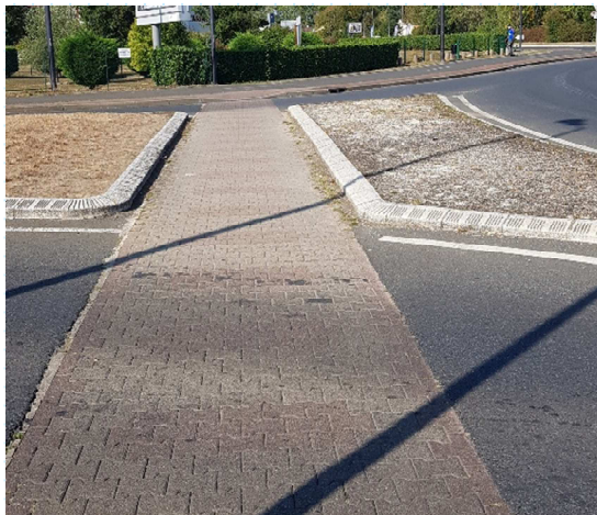
Traversées du giratoire RD191-RD153D sans marquages vélo et pas assez sécurisées
